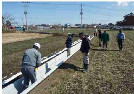
水路の更新が終わったら、完成検査を行い、すぐに財産管理台帳に整理する
